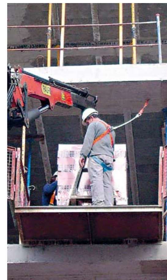
Un sistema útil desde el principio hasta el final de la obra.
